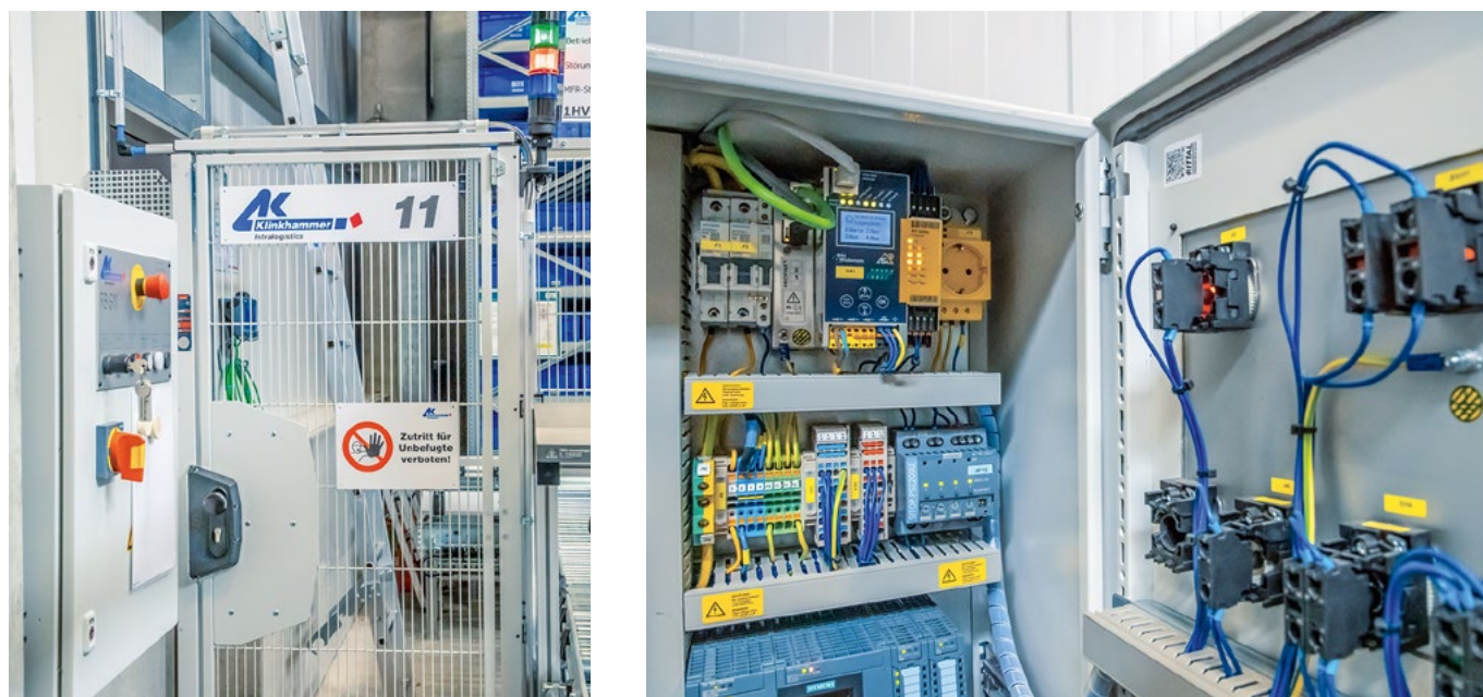
Puerta del callejón (izquierda), Panel de control con sistema de seguridad de B+W (derecha)
